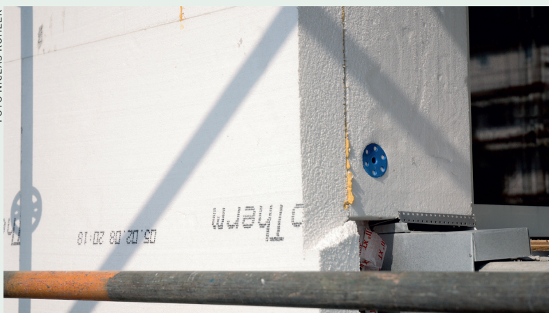
Kritiserad fasadteknik används i Hamnhuset på Norra Älvstranden i Göteborg.
